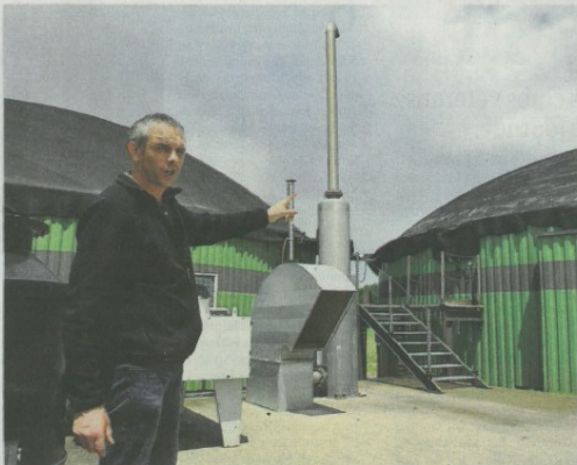
Dans les digesteurs, le gaz gonfle la bache, même s'il n'est pas sous pression. / Photo DDM, Marc Salvat
