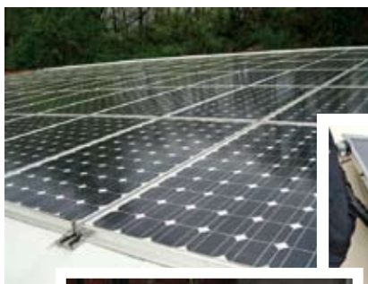
Panneaux solaires photovoltaïques
