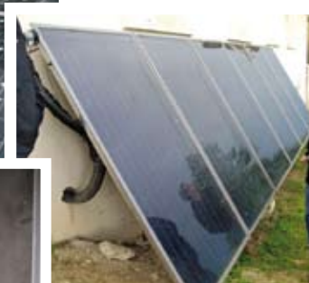
Panneaux solaires thermiques
